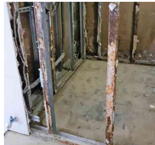
Die Montageelemente des verwendeten Vorwandsystems bei den Duschen setzten bereits Rost an.
