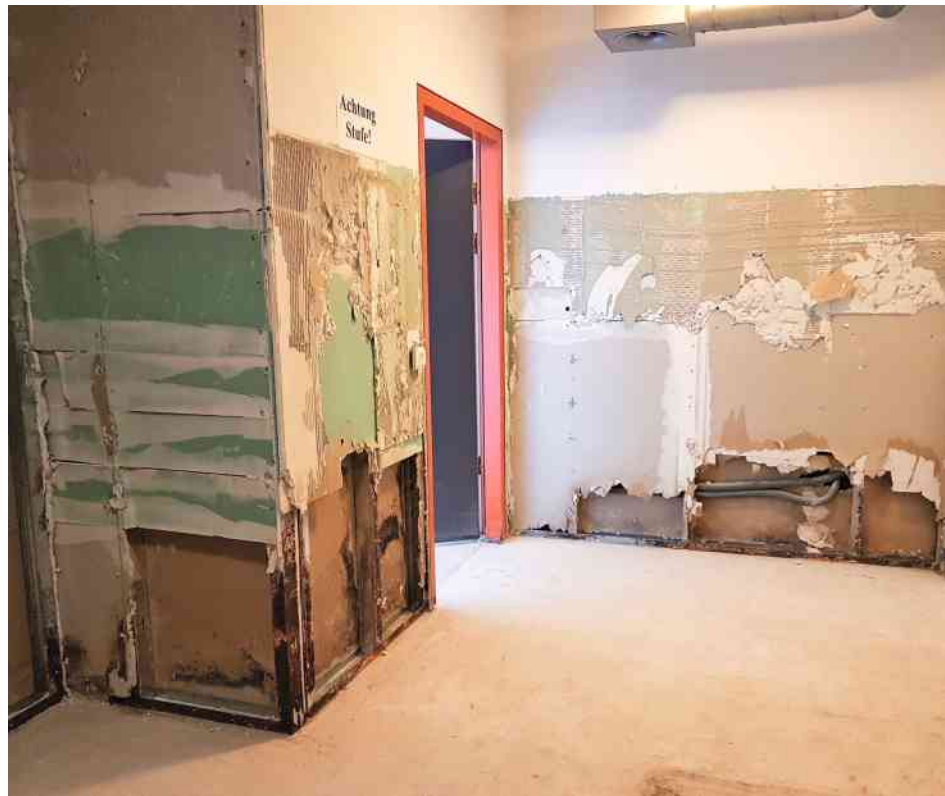
Die Kapillarwirkung des Wassers führte dazu, dass die eingesetzten Gips-Trennwände zwischen den Dusczellen und den Garderoben im Sockelbereich morsch waren. (Bilder: EBV Dienstleistungen GmbH, C. Savasta)
