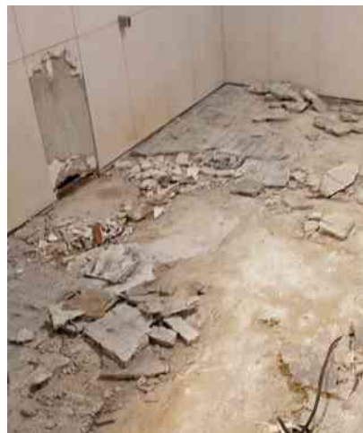
Baupfusch in der Dusche: Der Bodenbelag wurde ohne Wasserabdichtung verlegt. Durchnäste Zonen sind links im Bild zu sehen.
